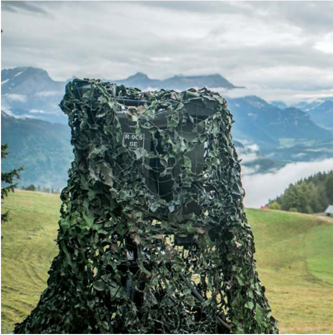
C'est au moyen d'antennes à ondes dirigées R-905 que le bat ondi 16 connecte les différents emplacements à son réseau.
